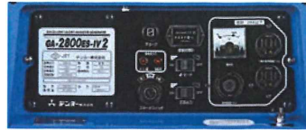
操作盤/コンセント
